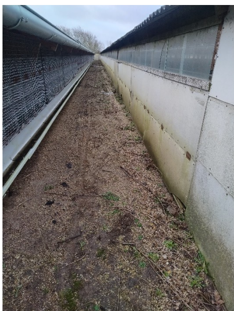
Billede 4—20. Minkfarme 4 – med asbestholdige facader.
